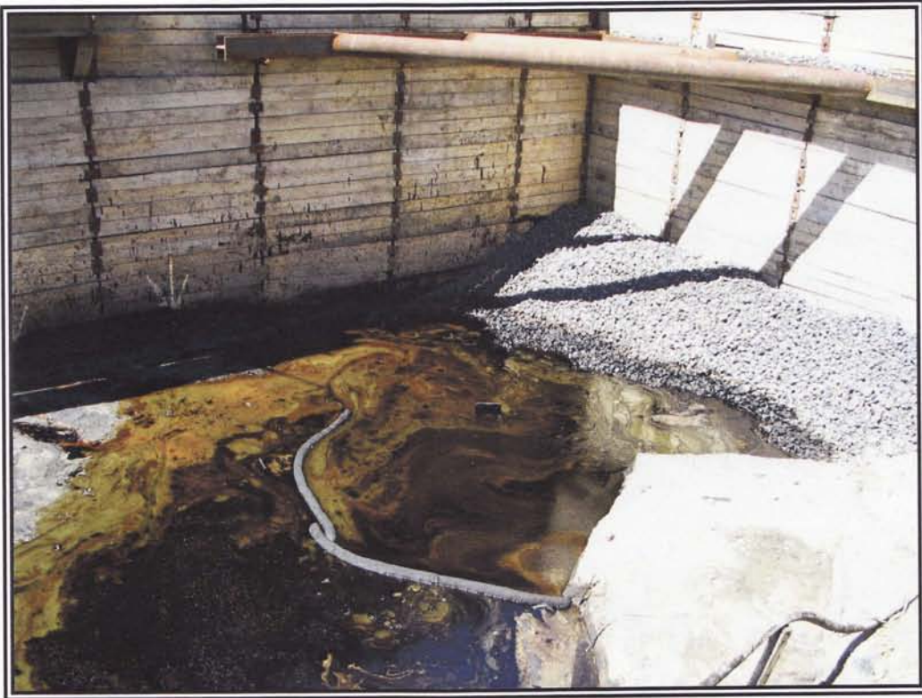
Photo no 1 : Infiltration des hydrocarbures le long du boulevard Rosemont
