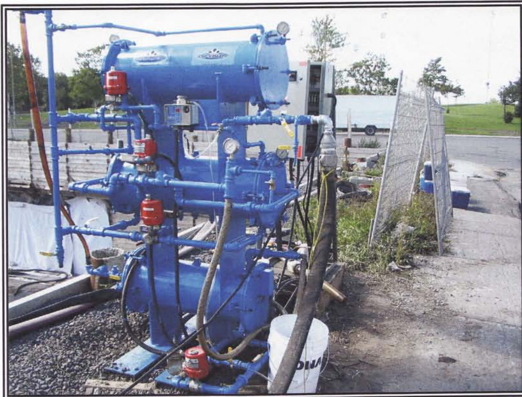
Photo no 2 : Module de traitement Separatech COP-System 08
